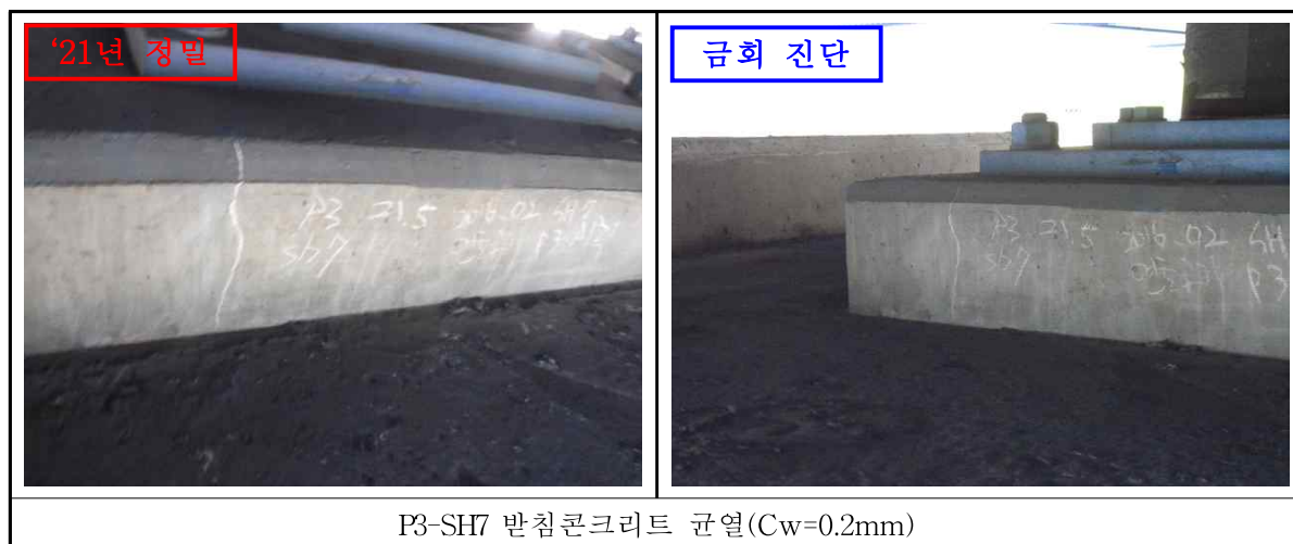
&lt;표 3.12&gt; 교량받침 외관조사 결과
